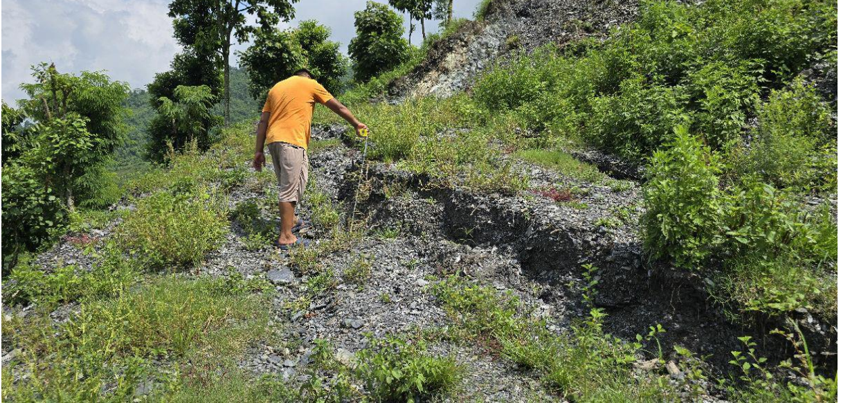
तस्विर: स्थानीय सडकको सतहमा देखिएको Mass Settlement Failure
